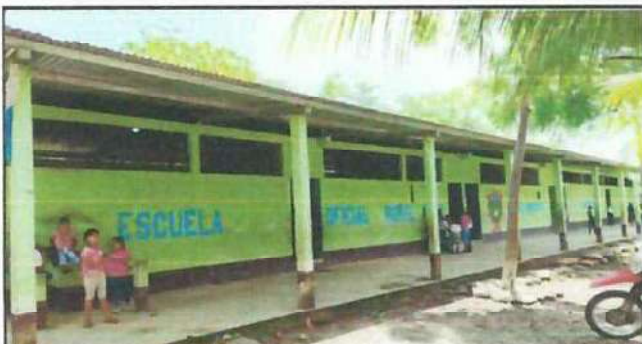
Foto 4: Se observa la necesidad de pintar las paredes interior y exterior de los módulos 1 y 2
