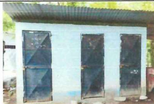
Foto 2: Se observa la necesidad de sustituir las puertas del módulo 2
