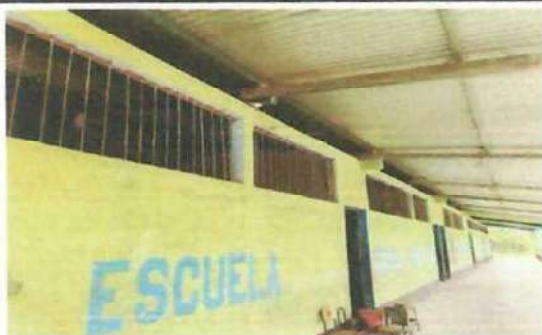
Foto 3: Se observa la necesidad de ampliar las ventanas del módulo 1 y sustituir las puertas
